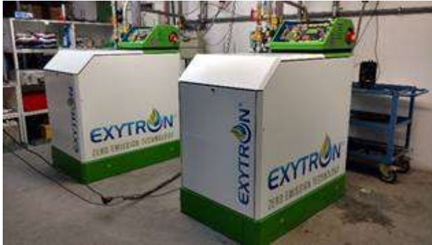
Installation der BHKW am BernsteinSee im Dezember 2018
